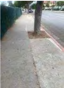
Hazard 6: 5146 El Carro Ln
