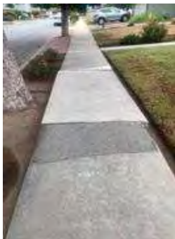
Hazard 16: 5405 El Carro Ln
