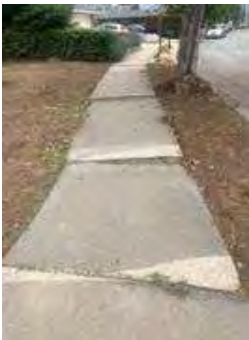
Hazard 7: 5366 El Carro Ln
