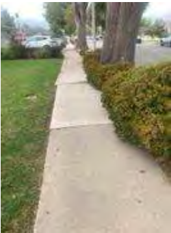
Hazard 21: 1317 Camino Trillado
