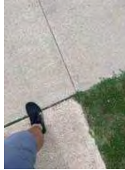
Hazard 10: 5004 Alvarado Rd
