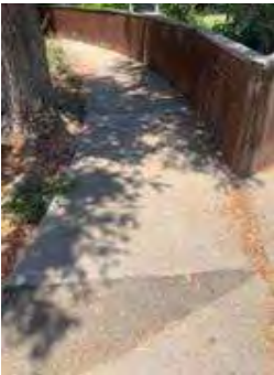
Hazard 2: 1484 Haida St
