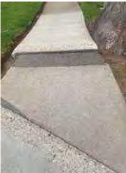
Hazard 23: 1305 Camino Trillado
