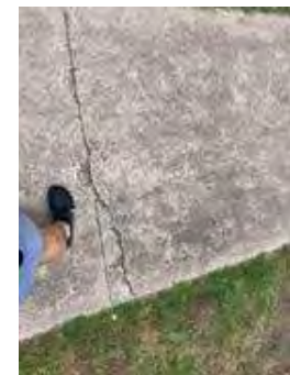
Hazard 8: 1536 Linden Ave
