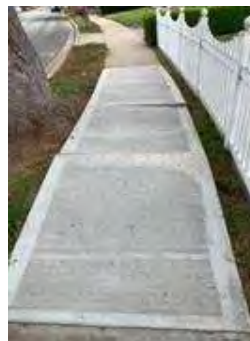
Hazard 26: 5450 El Carro Ln
