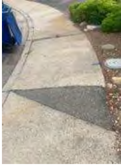
Hazard 10: 5489 Granada Way
