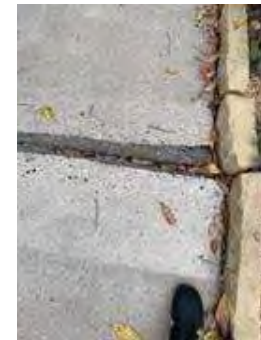
Hazard 35: 5363 Ogan Rd
