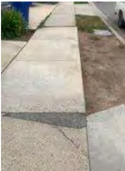
Hazard 4: 1492 Trenora St
