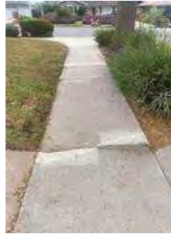
Hazard 2: 1304 Camino Trillado
