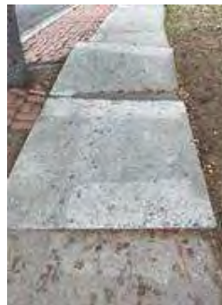
Hazard 35: 5366 El Carro Ln
