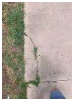
Hazard 7: 4952 El Carro Ln
