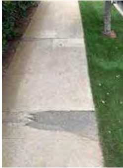
Hazard 33: 5347 Ogan Rd
