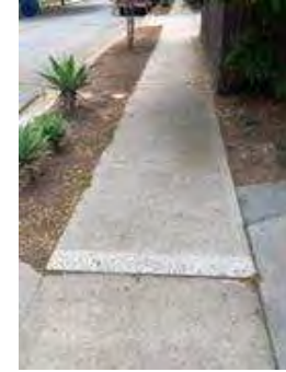
Hazard 26: 1290 Vallecito Rd
