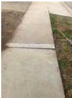
Hazard 16: 1423 Camino Trillado
