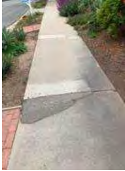
Hazard 28: 5428 El Carro Ln
