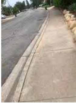
Hazard 1: 1382 Camino Trillado C^sw
