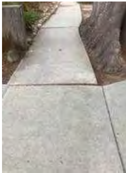
Hazard 4: 1316 Camino Trillado
