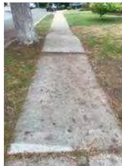
Hazard 17: 5431 El Carro Ln
