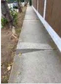
Hazard 19: 5383 Ogan Rd
