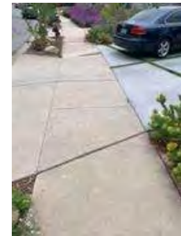
Hazard 29: 5321 Ogan Rd
