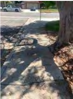
Hazard 5: 1309 El Portal Ave
