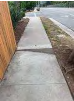
Hazard 9: 5491 El Carro Ln
