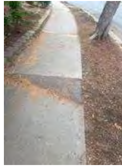
Hazard 14: 5381 El Carro Ln
