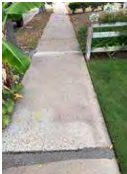
Hazard 34: 5359 Ogan Rd
