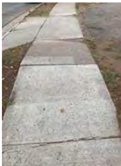
Hazard 34: 5366 El Carro Ln
