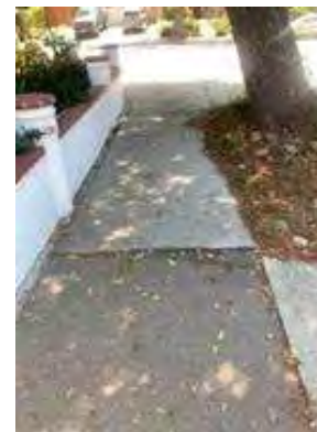
Hazard 2: 1478 Noma St
