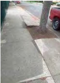
Hazard 4: 5048 El Carro Ln
