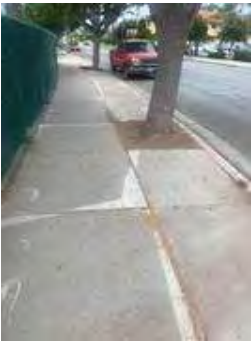
Hazard 5: 5048 El Carro Ln
