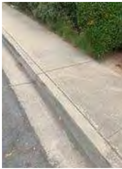
Hazard 13: 5466 Granada Way Sw^c
