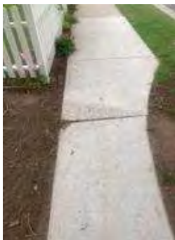
Hazard 7: 1334 Camino Trillado
