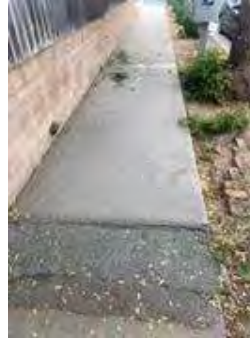
Hazard 11: 5404 Granada Way
