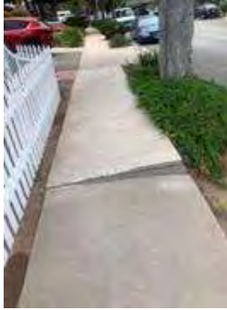
Hazard 10: 5360 Ogan Rd
