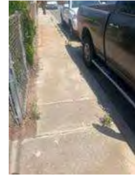
Hazard 3: 5042 Alvarado Rd
