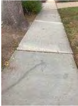
Hazard 1: 1304 Camino Trillado
