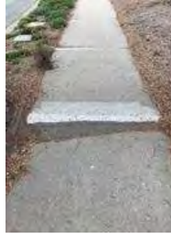
Hazard 29: 5418 El Carro Ln
