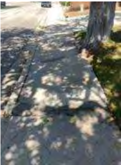
Hazard 2: 1362 El Portal Ave
