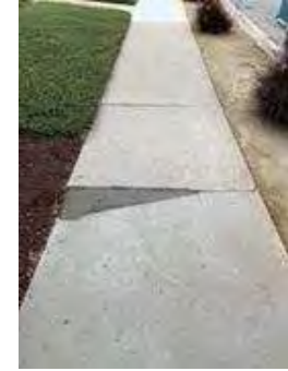
Hazard 21: 5481 El Carro Ln
