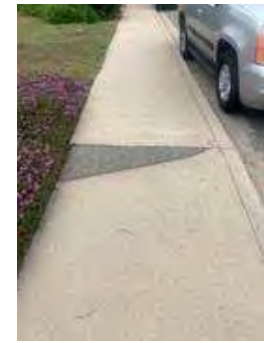
Hazard 15: 5450 Granada Way
