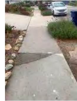
Hazard 3: 1310 Camino Trillado
