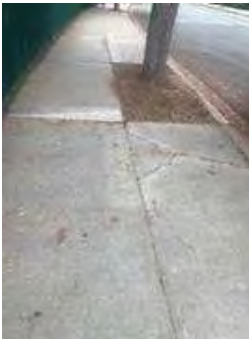
Hazard 7: 5146 El Carro Ln
