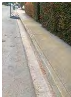
Hazard 8: 5461 Granada Way Sw^c
