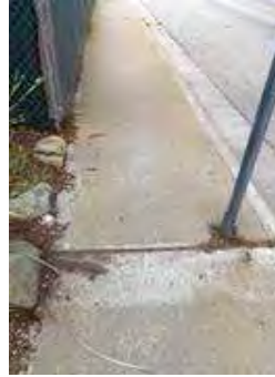
Hazard 25: 1275 Vallecito Rd
