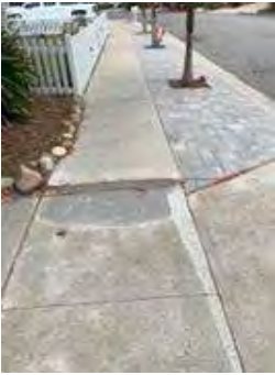
Hazard 15: 5461 Cameo Rd
