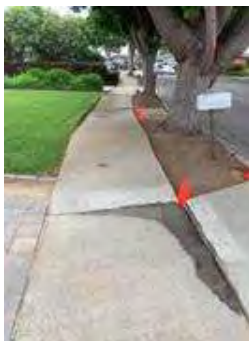
Hazard 25: 5458 El Carro Ln
