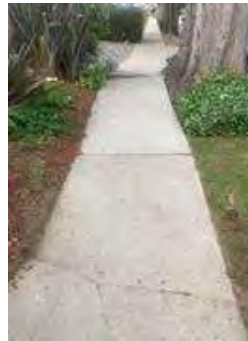
Hazard 5: 1328 Camino Trillado
