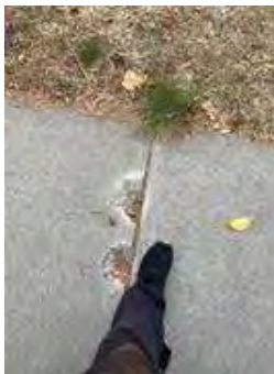
Hazard 16: 5497 Granada Way
