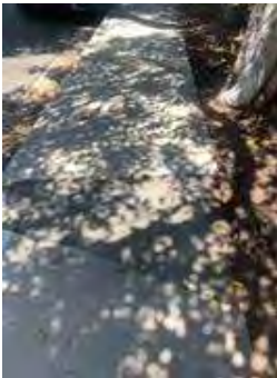
Hazard 1: 5360 Ogan Rd
