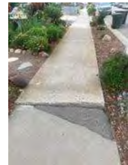
Hazard 18: 1341 Camino Trillado
