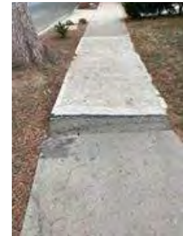
Hazard 24: 5470 El Carro Ln
