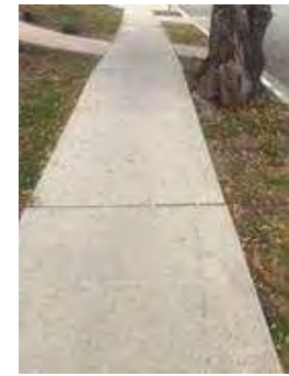
Hazard 15: 1451 Camino Trillado
