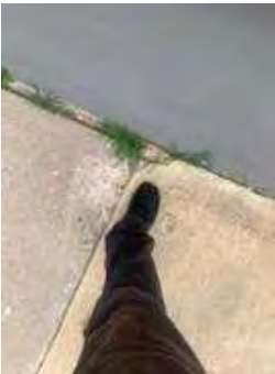
Hazard 3: 1482 Trenora St
