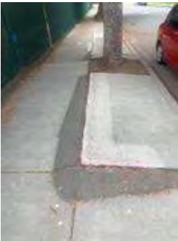
Hazard 2: 5048 El Carro Ln
