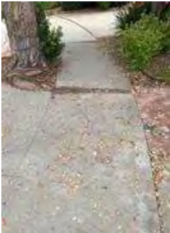
Hazard 10: 5401 Cameo Rd
