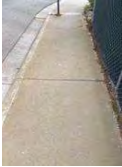
Hazard 24: 1275 Vallecito Rd
