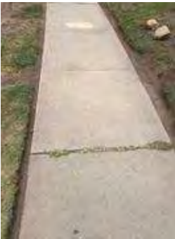
Hazard 19: 1305 Camino Trillado
