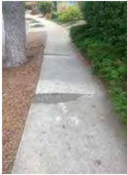
Hazard 13: 1486 Camino Trillado
