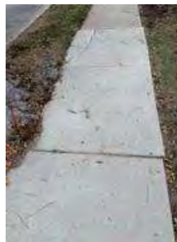
Hazard 37: 5375 Ogan Rd
