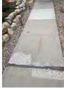
Hazard 40: 5383 Ogan Rd
