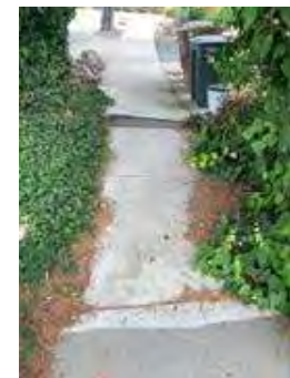
Hazard 38: 5379 Ogan Rd
