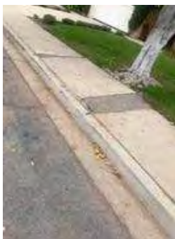
Hazard 16: 5442 Granada Way
