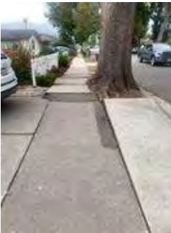
Hazard 20: 1323 Camino Trillado
