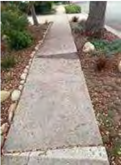
Hazard 12: 5433 Cameo Rd
