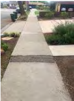
Hazard 22: 1317 Camino Trillado
