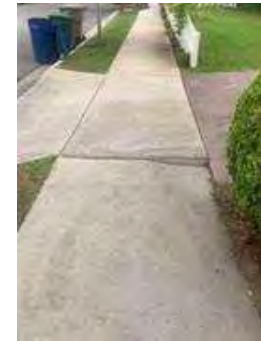
Hazard 6: 1328 Camino Trillado
