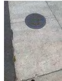
Hazard 5: 4952 El Carro Ln
