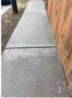
Hazard 10: 5491 El Carro Ln
