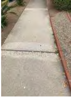
Hazard 10: 5404 Granada Way
