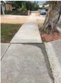
Hazard 1: 1483 Trenora St
