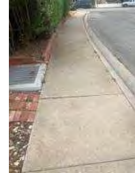
Hazard 3: 1382 Camino Trillado
