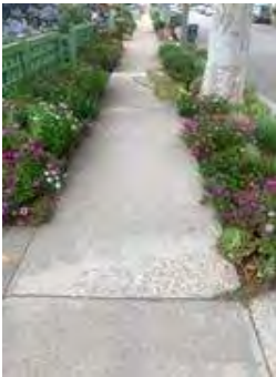
Hazard 19: 1335 Camino Trillado
