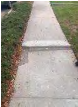
Hazard 4: 5376 Ogan Rd
