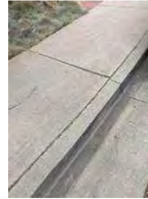
Hazard 2: 5415 Hales Ln Sw^c
