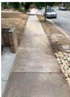
Hazard 30: 5325 Ogan Rd
