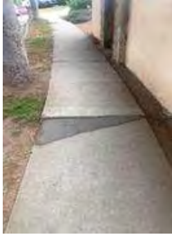
Hazard 19: 5455 El Carro Ln
