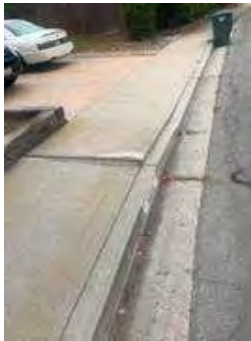
Hazard 4: 5404 Granada Way
