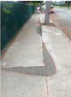
Hazard 3: 5048 El Carro Ln
