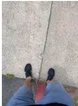
Hazard 5: 4952 El Carro Ln
