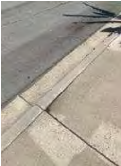
Hazard 4: 1363 El Portal Ave C^sw
