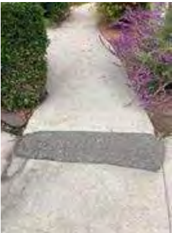
Hazard 9: 5402 Cameo Rd
