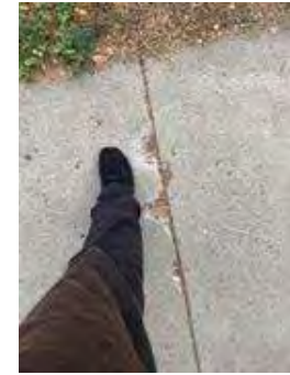
Hazard 15: 5498 Granada Way
