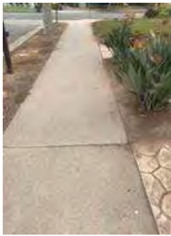
Hazard 13: 1486 Camino Trillado
