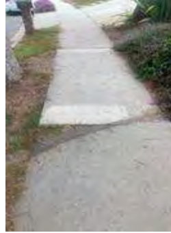
Hazard 20: 5471 El Carro Ln
