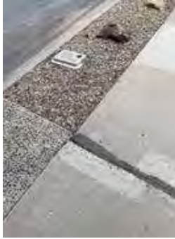
Hazard 39: 5383 Ogan Rd
