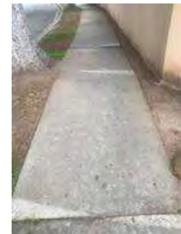
Hazard 18: 5455 El Carro Ln
