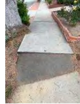
Hazard 30: 5408 El Carro Ln
