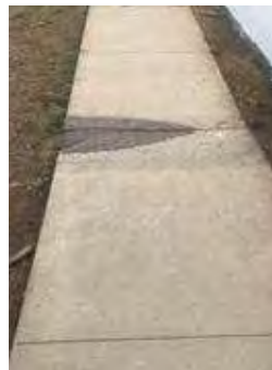
Hazard 17: 1423 Camino Trillado
