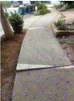
Hazard 2: 1483 Trenora St
