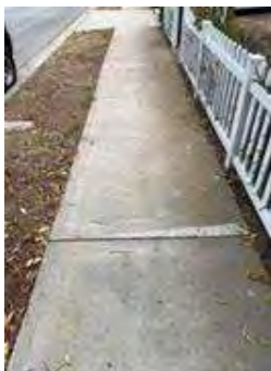
Hazard 36: 5367 Ogan Rd
