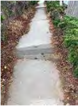
Hazard 31: 5487 Cameo Rd
