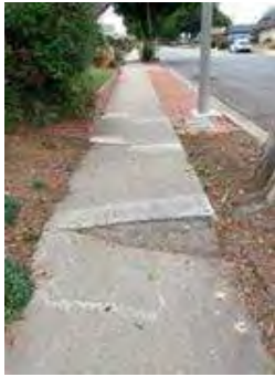
Hazard 31: 5398 El Carro Ln
